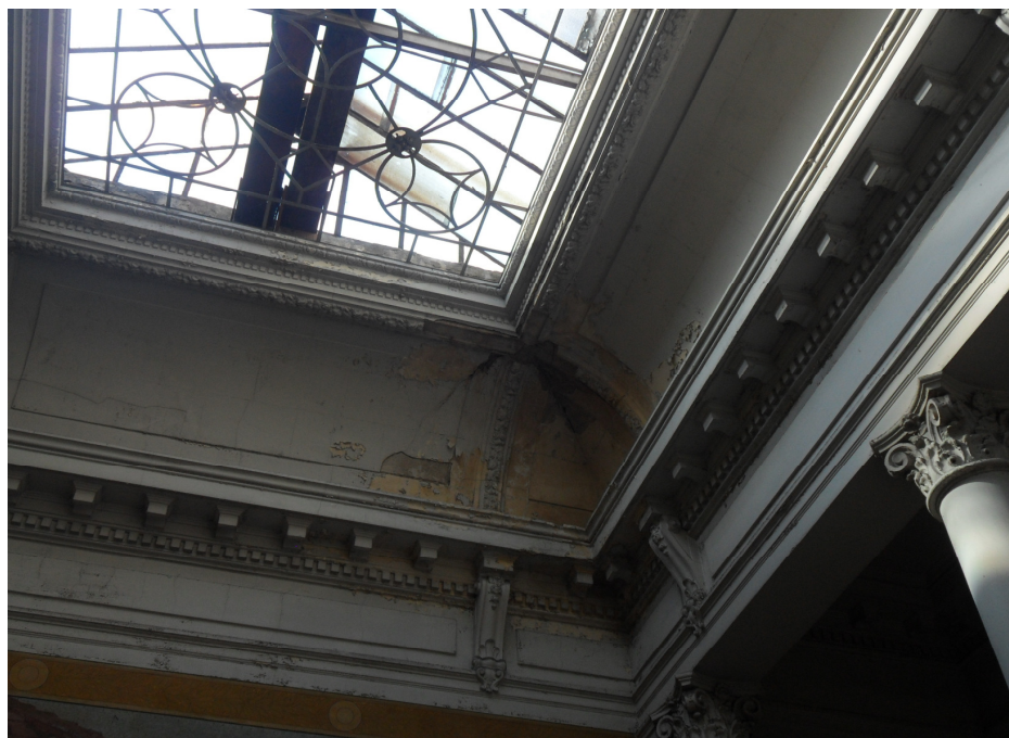
Zonas de humedad, filtraciones, impacto directo del sol, que están ubicadas encima de la obra
