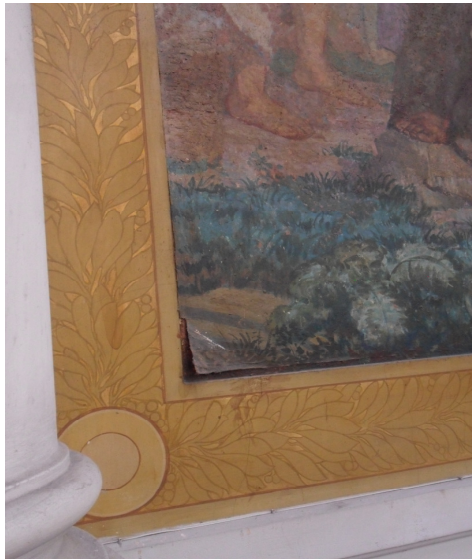
Desprendimiento de la arpillera
